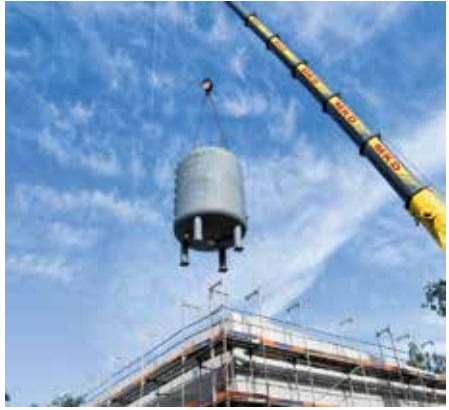
Die tonnenschweren Filterkessel kamen bereits Anfang Juli. Foto: ac
